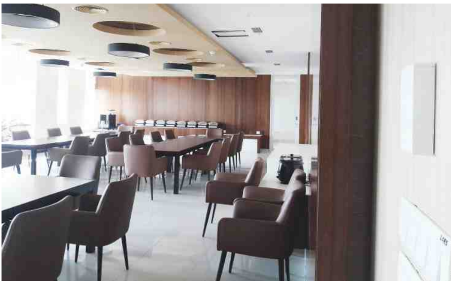
班加罗尔园区一间餐厅安装的暖通空调传感器（印度班加罗尔）。
