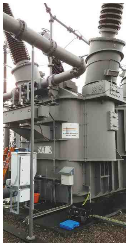
安装在电力变压器中的维萨拉 Optimus DGA。
